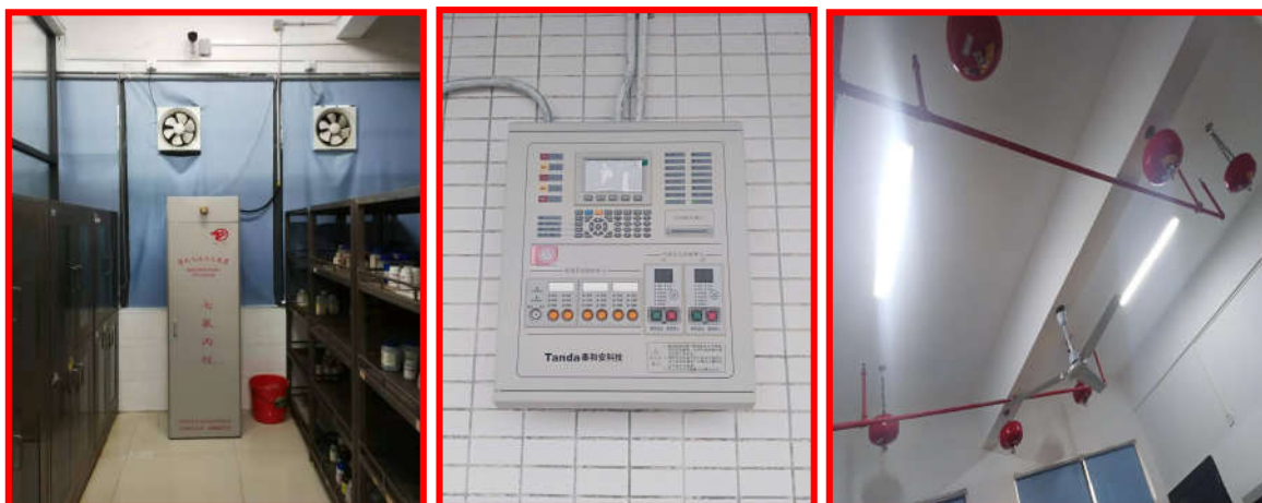
图 2 灭火设备（左一、二图为理工楼 709 仓库全自动气体灭火装置； 右侧为理工楼 708 有机准备间全自动干粉灭火器
